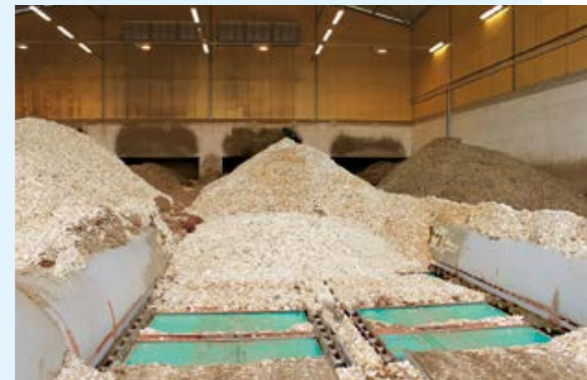
Haketta syötettävänä kuljettimelle, joka siirtää polttoaineen voimalaitokseen.
